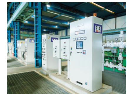
脱水機を制御する電気設備
